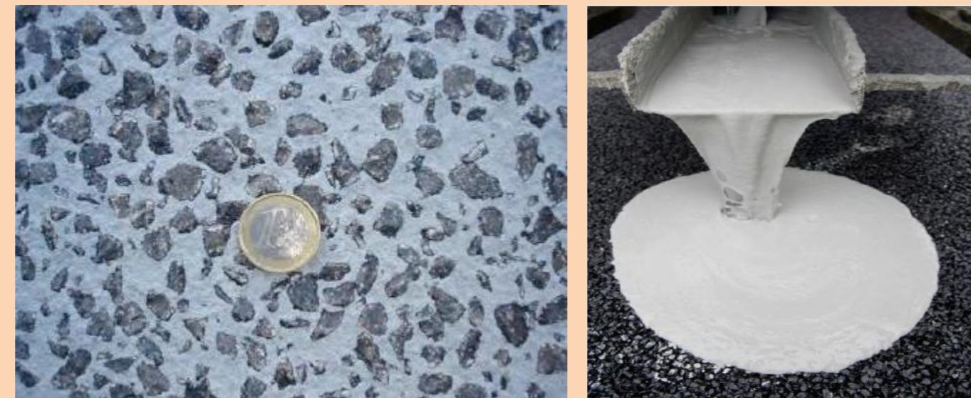
Estado de la superficie de rodadura tras percolación de la lechada después del granallado
